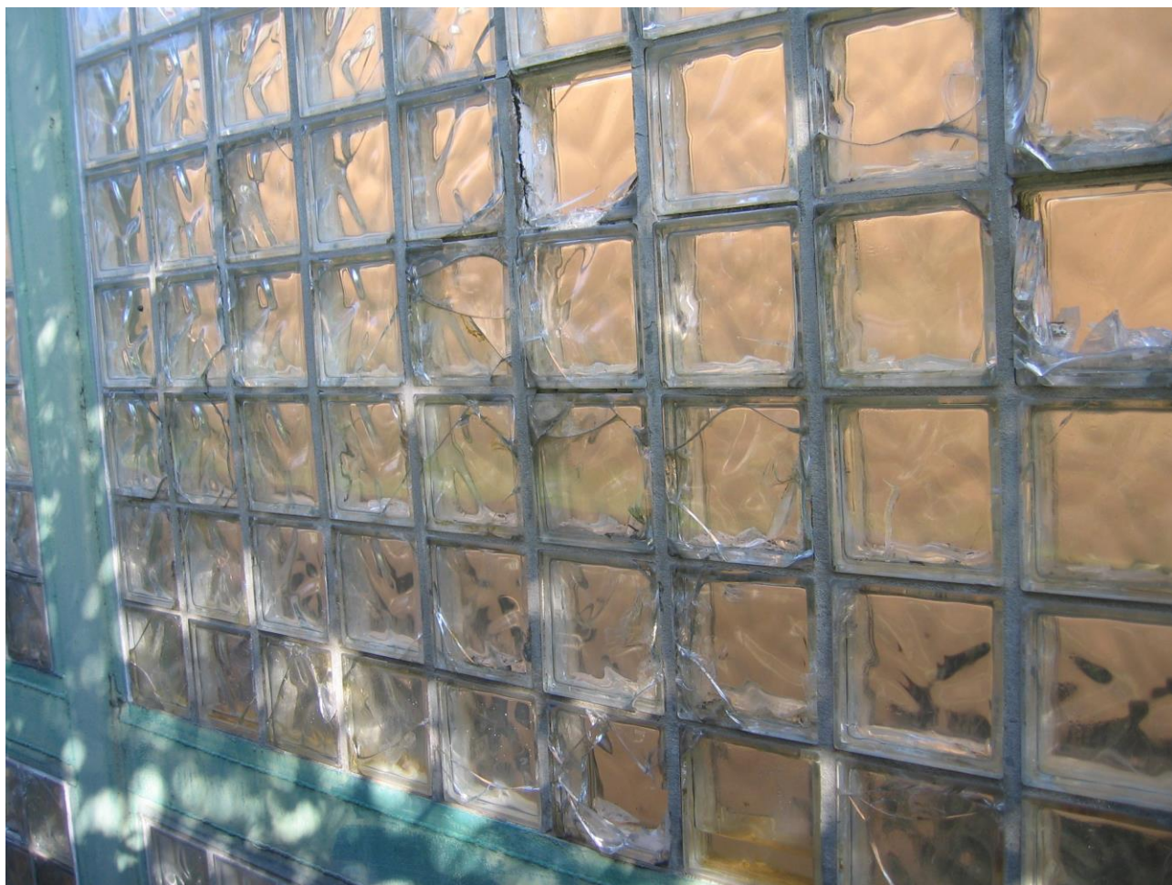
Jedno z poškozených polí na jižní fasádě
